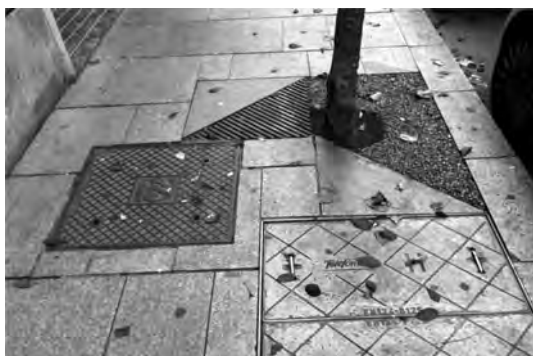
Figura 3.19: Planificación de instalaciones incompatible con el arbolado. Calle Serrano, Madrid.
