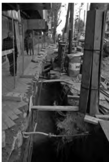
Figura 3.18: Eliminación peligrosa del 50% de las raíces para la reforma de la calle Serrano, Madrid.
