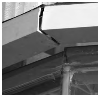
Figura 5.31: Remate de cubierta levantado.
